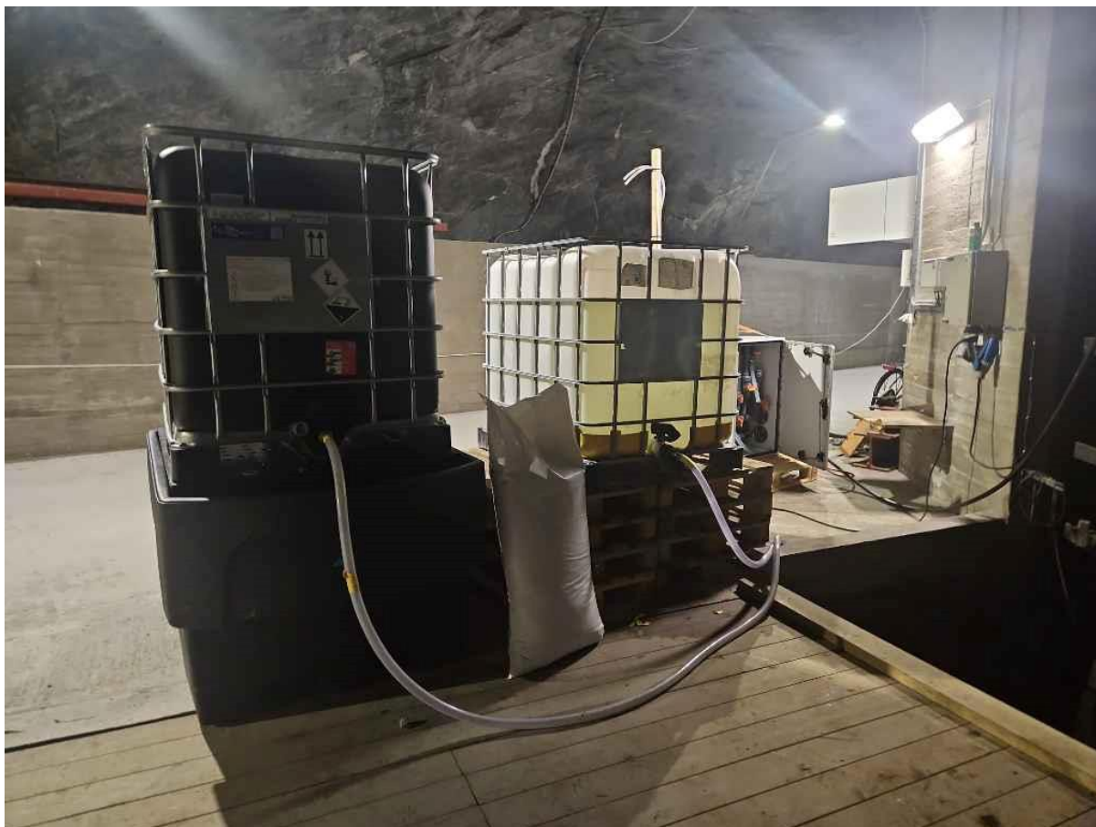
Figur 11. Kjemikalier og doseringsskap i Driva kraftverk. Foto Jarle Håvardstun/NIVA
