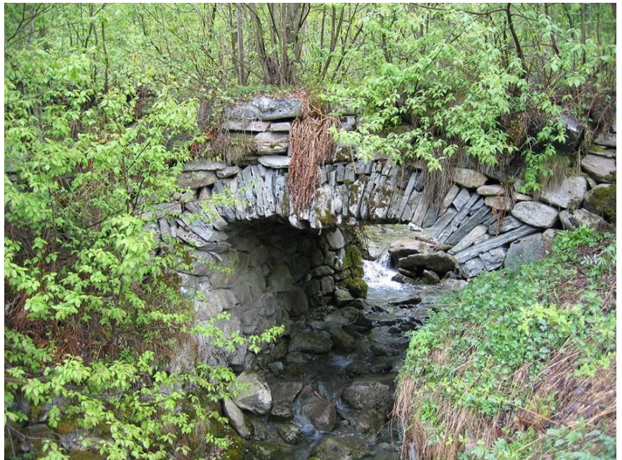
Lauvåbrua er et eksempel på praktfullt steinarbeid og må bevares. Her haster det med å gripe tak og restaurere den
