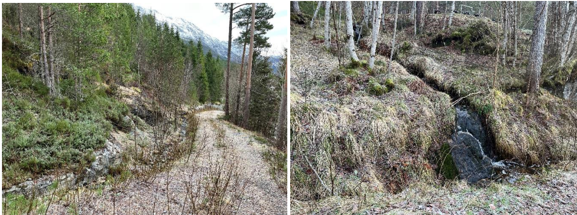
Figur 4 Grøft langs skogsveg og bekk på fjell.
