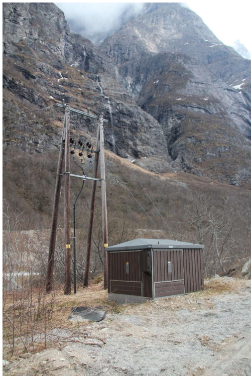
Trafo ved Hårstad.
