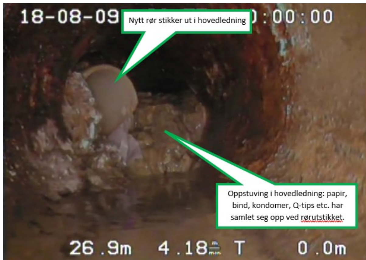
Figur 20: Eksempel på oppstuvning i spillvannsledning
