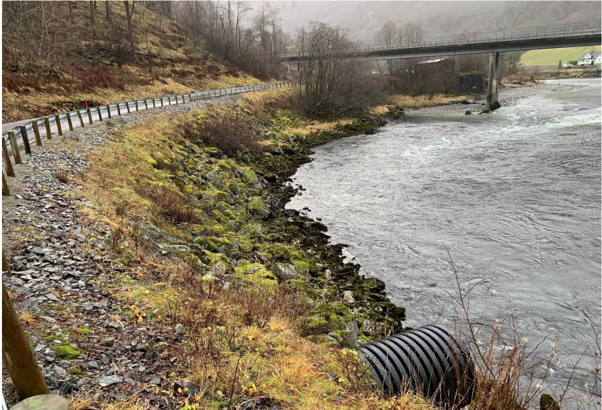
FIGUR 7-3 Område 4 Fv.6140 pr. 440 mot BP 122. Skråning fra Driva opp mot Brekkhaugen. Steinplastring i yttersving.
